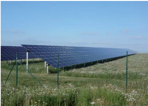
Photovoltaikanlage bei Obernbreit
